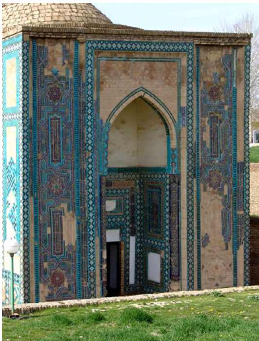
Abb. 3: Zustand 1998 nach erster Restaurierung um 1960. Fehlstellen im Keramikdekor zurückhaltend und materialkonform zum Bestand ergänzt
