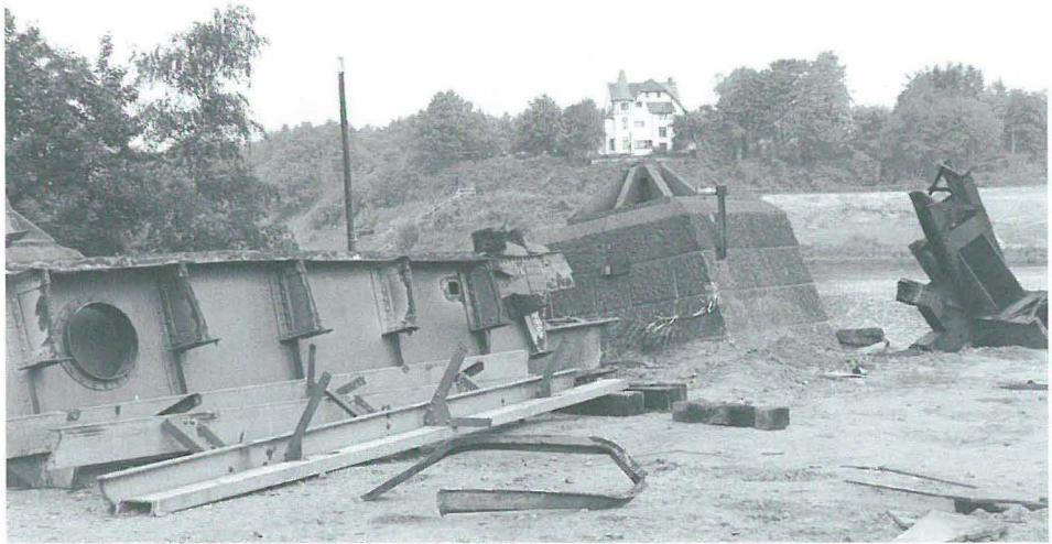
Abb. 21 Überreste der alten Hochbrücke in Kiel-Holtenau (1992).
