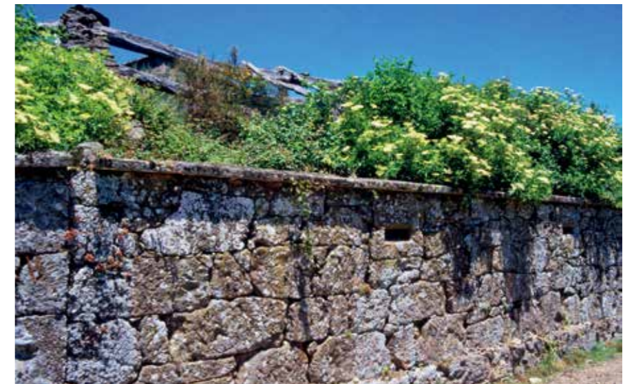
Umfassungsmauer desselben Anwesens mit Schießscharten ( seteiras ). Dahinter eingefallenes Dach eines Wirtschaftsgebäudes. Hohe Holunderbüsche ( sabugueiros ) als typische Ruderalpflanze. Covelães, Montalegre, Juni 2007.
