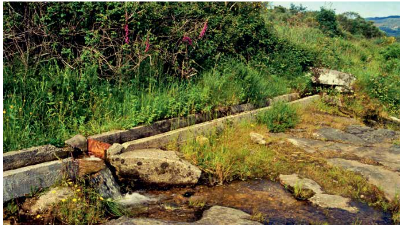
Betonierter, nahezu isohypsenparalleler Kanal ( levada ) zur Bewässerung in den 1980er Jahren im Rahmen des Entwicklungsplanes für Trás-os-Montes gebaut; vermutlich unsachgemäße Wasserentnahme an beschädigter Stelle. Covelães, Montalegre, Juni 2007.
